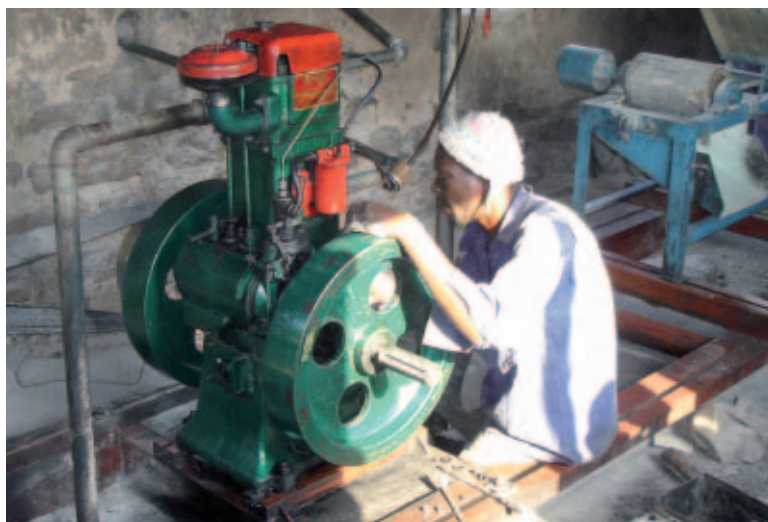
Foto Generant electricitat des de la plataforma multifuncional de Seneso, a Ghana.
